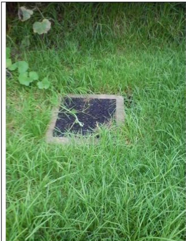
Fotografía 4. Caja a la cual se conectará la entrega de aguas residuales tratadas (PETAR C.C.BIMA). Sector nor-occidental del predio.
